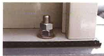
空調機・室外機下部
